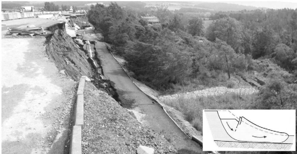
Fotografía 2: Panorámica parcial del deslizamiento y esquema de forma de rotura (el pie queda a la derecha, fuera de la fotografía).
