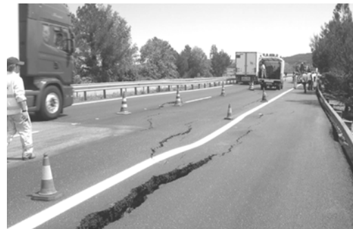
Fotografía 1: Grietas y escalones previos a la rotura completa
